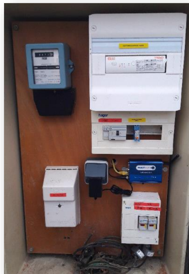
Après mise en place de la télégestion
